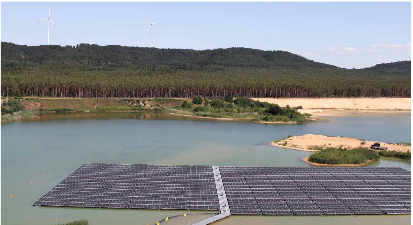
Schwimmende Photovoltaikanlage auf Baggersee, Fa. Max Bögl
