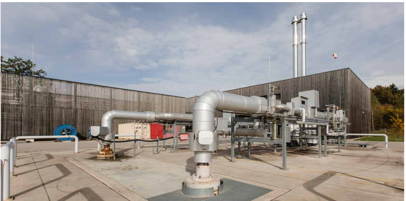
Geothermieanlage Laufzorn / Grünwald.
